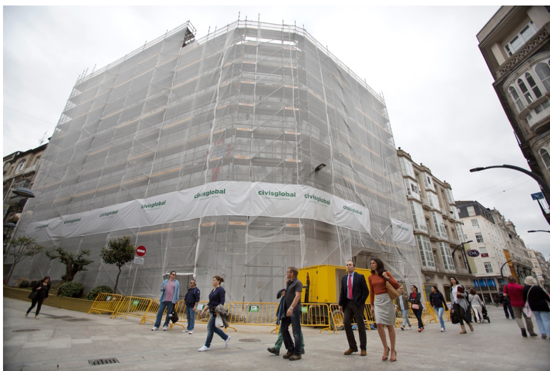
Obras de rehabilitación y construcción de la nueva sede social del Celta, en la calle del Príncipe (Vigo).
